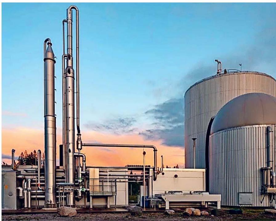
Sävsjö biogasanläggning. Foto: Blond
